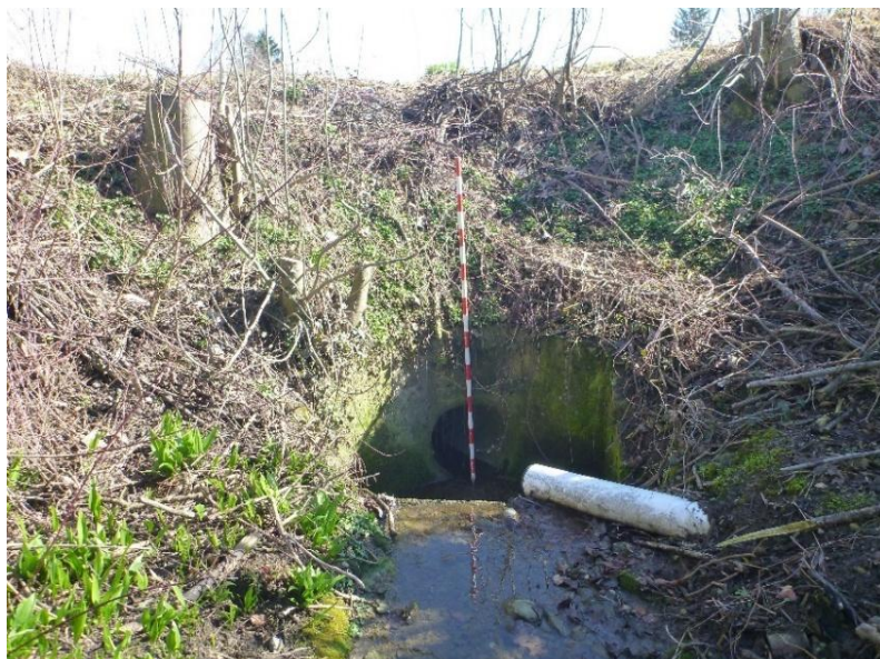
Einlauf Eindolung ZR DN500, km 0.450
