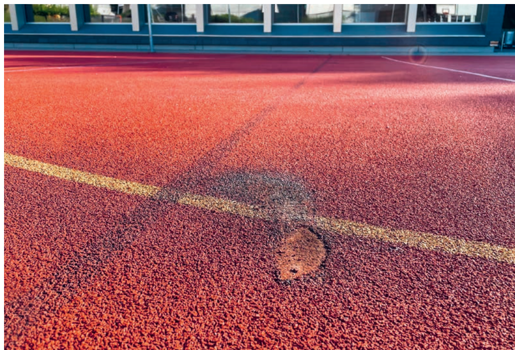
Die Behebung der Schäden verursacht hohe Kosten.
