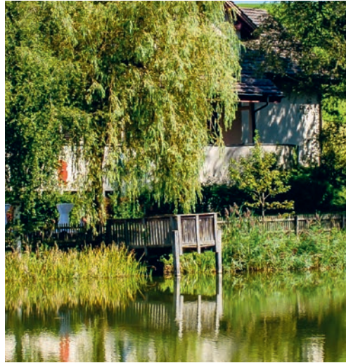
Die Reparatur des beschädigten Stegs kann frühestens im September erfolgen.
