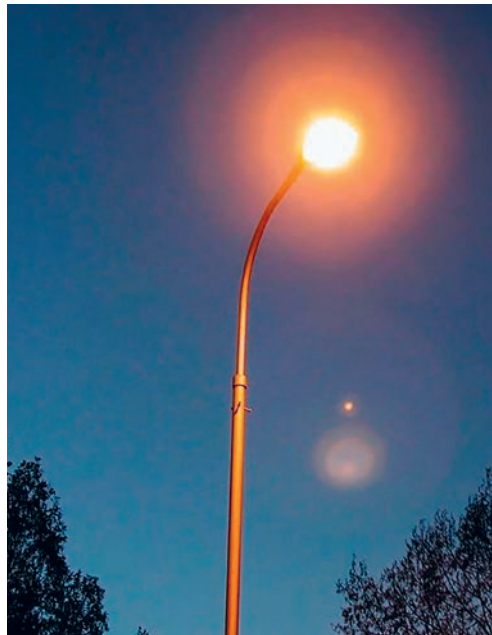
Die nächtliche Beleuchtungszeit wird wieder um insgesamt eine Stunde ausgedehnt.
