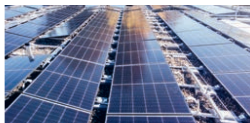
Die bereits realisierte Photovoltaikanlage auf dem Dach des Oberstufenschulhauses.
