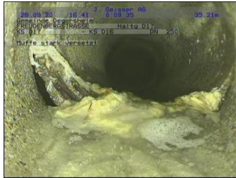
Bild 79 35,5 m Muffe stark versetzt
