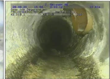
Bild 47 10,9 m Einlauf rechts schlecht verputzt
