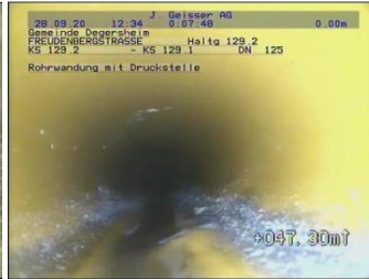
Bild 3 47,4 m Rohrwandung mit Druckstelle
