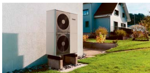
Luft-Wasser-Wärmepumpe, aussen aufgestellt.
