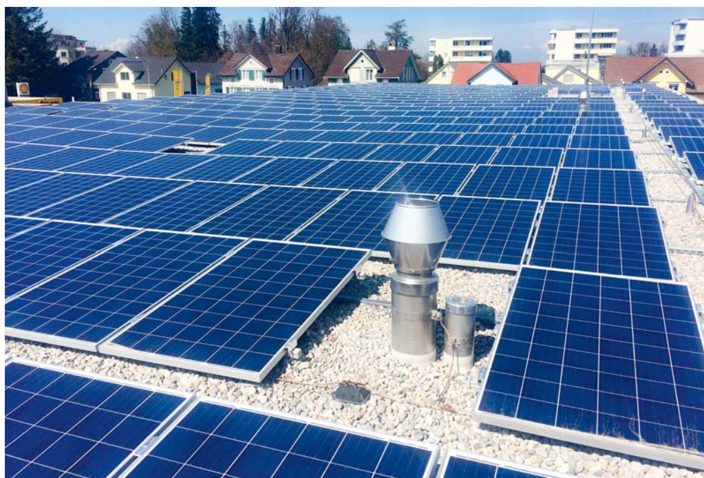
Photovoltaik-Anlage auf dem Dach des Feuerwehrdepots: Flawil wird für weitere vier Jahre mit dem Label Energiestadt ausgezeichnet.
