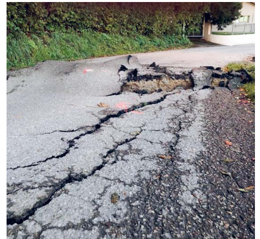
Durch den Hangrutsch wurde ein Abschnitt der Stockenstrasse stark beschädigt.
