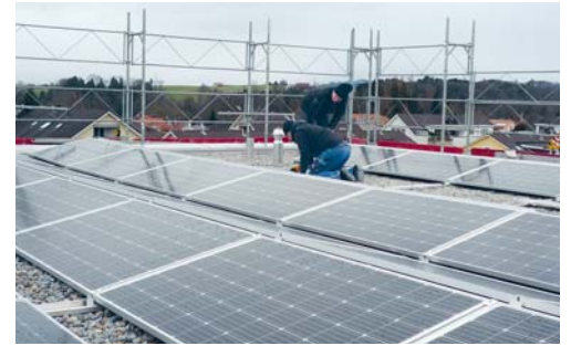
Blick auf die Photovoltaikanlage auf dem Dach der Alterssiedlung Feld.
