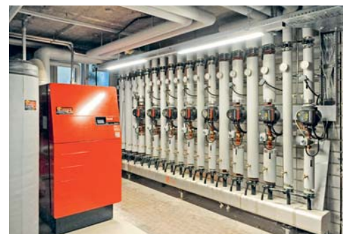
Der neue Heizungsraum der Oberstufe
