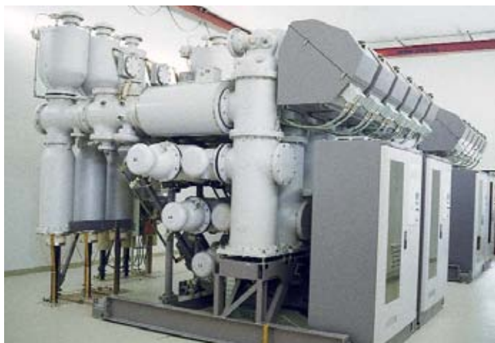
4 Neue SF6 Schaltanlage 50 kV im neuen Unterwerk der SAK in Herisau.
